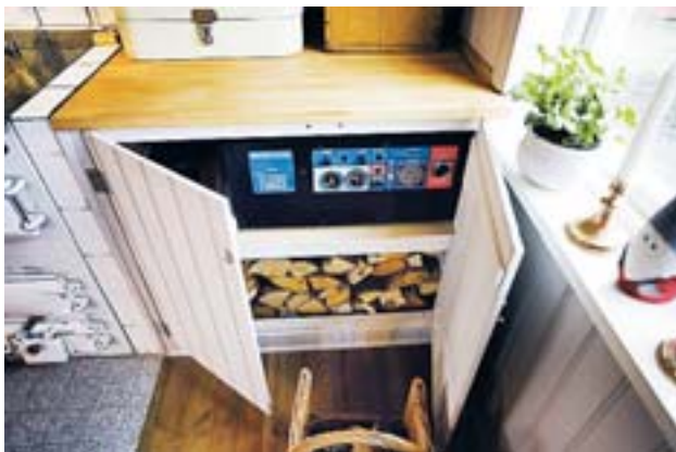
Äntligen färdigt! Intill spis och vedpanna har familjen byggt ett skåp med plats för elpanna och ved.
